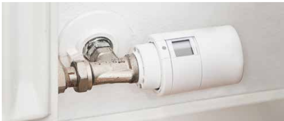
På fire værelser i huset har familien Anker nu Danfoss Ally™ radiatortermostater.
